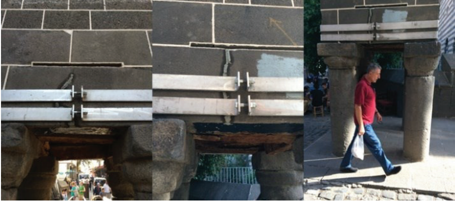
Şekil 3. Dört Ayaklı Minarede görülen hasarlar
